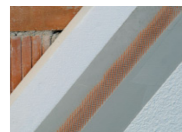
Construcción de ladrillo con Aislamiento Styrofoam - Temperatura inicial: 19°C
